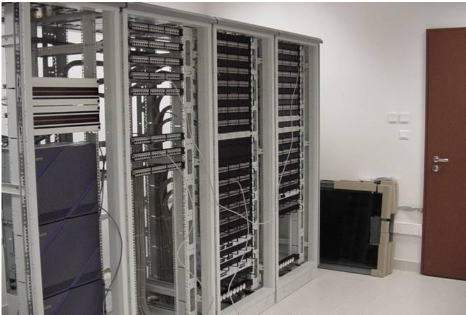
Рис. 2.1. Главный коммутационный узел здания смонтированной СКС на 350 рабочих мест
