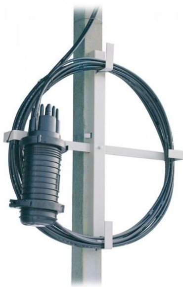
Рис. 10.4. Запас оптического кабеля вдоль опоры освещения
