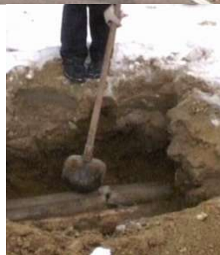
Рис.5.11. Просаживание грунта и повреждение кабельной канализации
