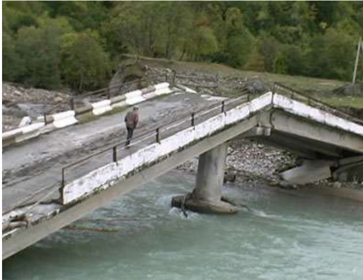
Рис.5.16. Разрушение мостов и эстакад в результате наводнений, оползней.
