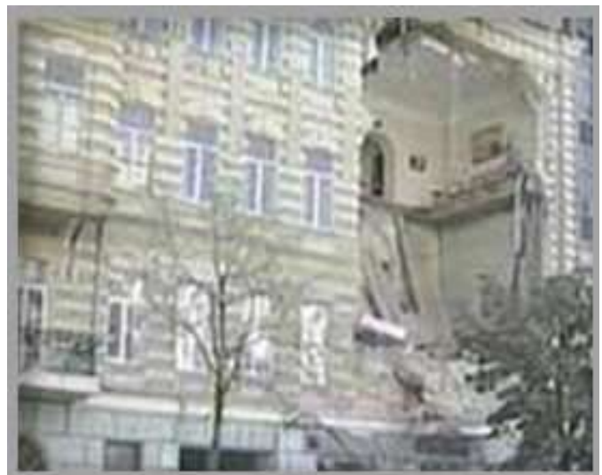
Рис.5.15. Обрушение и просаживание фундаментов зданий.
