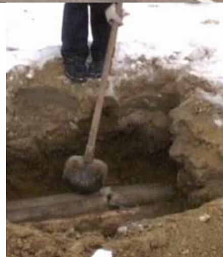
Рис.5.11. Просаживание грунта и повреждение кабельной канализации
