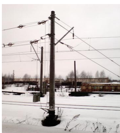
Рис.8.3. Опоры контактной сети ЭЖД
