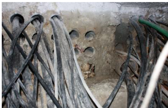
Рис. 6.17. Внутренний вид кабельного колодца
