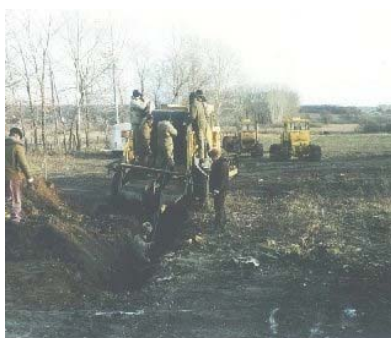
Рис. 5.7. Прокладка ВОК в плохо подготовленную траншею
