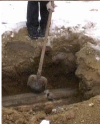
Рис. 5.11. Просаживание грунта и повреждение кабельной канализации
