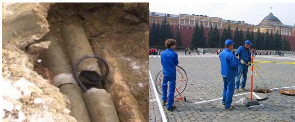
Рис. 3.6. Кабельная канализация и ее повреждения
