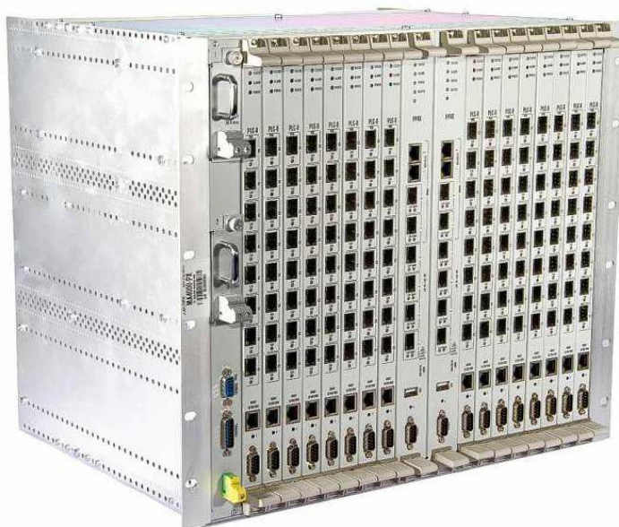
Рис.5.1. Внешний вид коммутатора OLT PON в конструктиве шасси (коммутатор GPON OLT MA4000-PX производства ООО «Предприятие «Элтекс», Россия).
